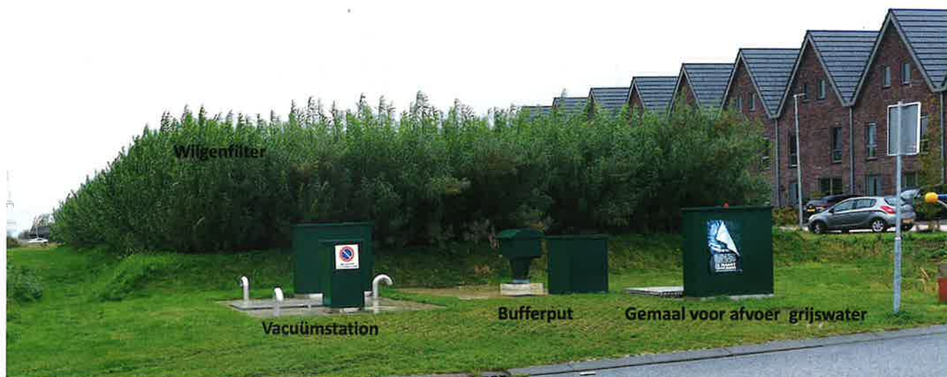
Opstelling wilgenfilter in Reitdiep te Groningen.
